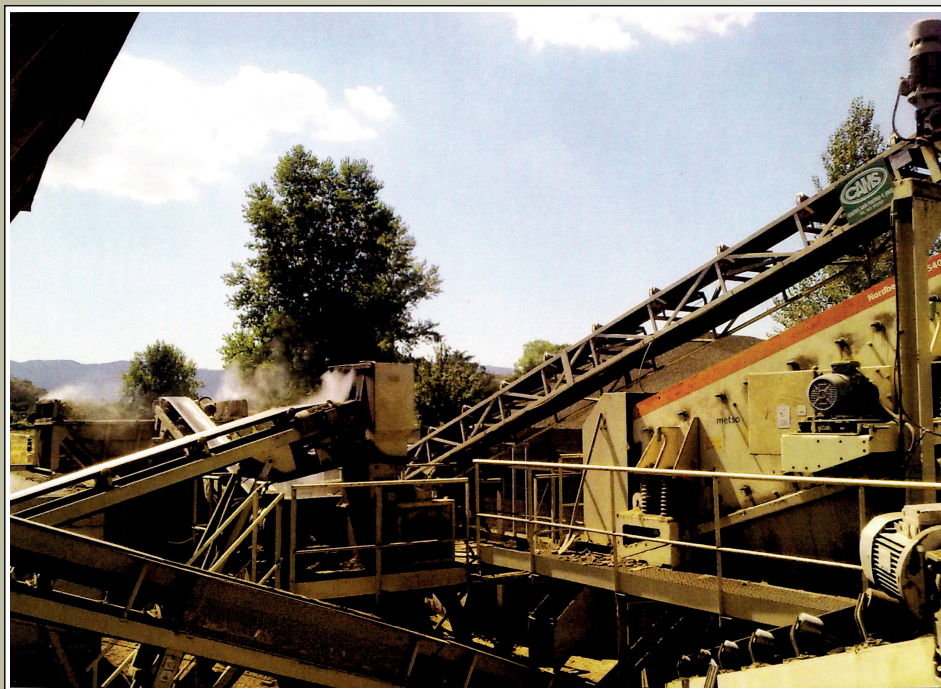
После установки системы туманообразования
